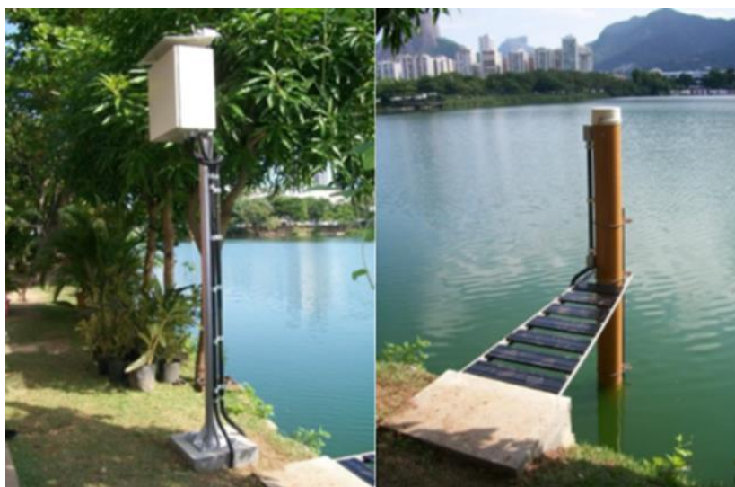
Figura 6. Estação de monitoramento. 6
